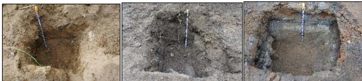
Fig.núm.4. Les tres cales de fonamentació dels fanals realitzats en el sector de les naus industrials.
